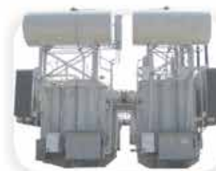
ترانسفورماتور تغییر دهنده فاز
