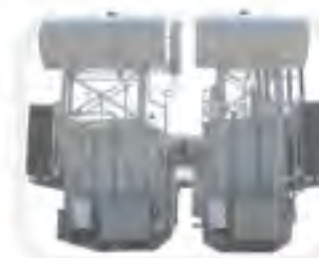
ترانسفورماتور تغییر دهنده فاز
