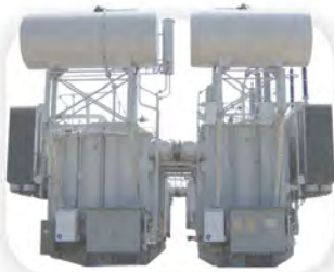
ترانسفورماتور تغییر دهنده فاز
