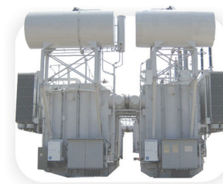
ترانسفورماتور تغییر دهنده فاز
