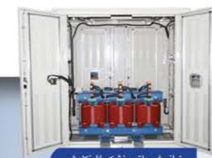
ترانسفورماتور خشک با اینکلوزر توان ۱۲۵ kVA، ولتاژ ۰.۴/۰.۴۲ kV
