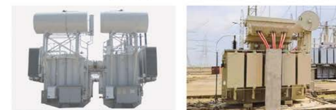
ترانسفورماتور تغییر دهنده فاز راکتور
